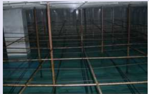
《내부보강(기존기술) 물탱크 내부》
